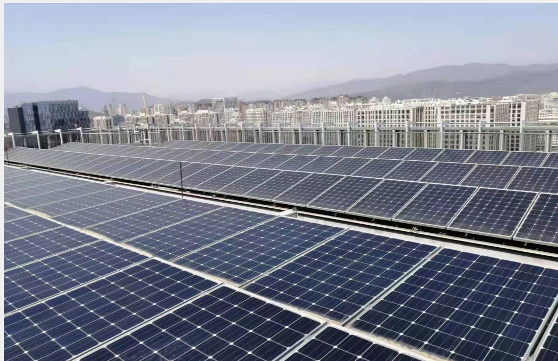
金融街（长安）中心屋面光伏板发电设施
